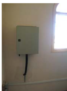
Grand répartiteur au niveau de la salle d'acquisition
