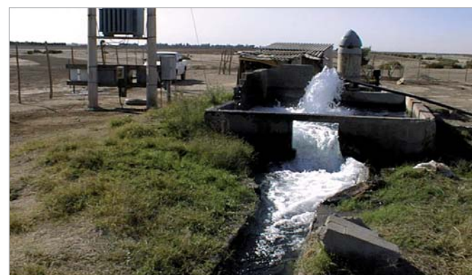
A lo largo y ancho de las regiones áridas, el agua para la población es frecuentemente obtenida mediante estaciones de bombeo (foto PROMMA).
