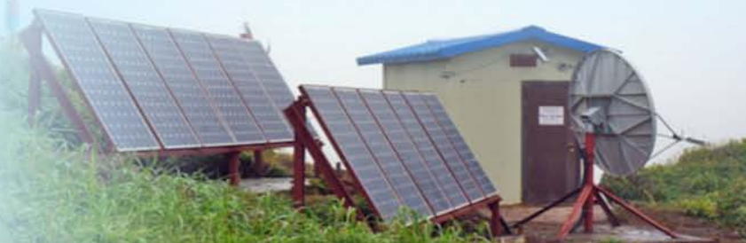
Новый автоматизированный пост СПЦ на острове Симушир
